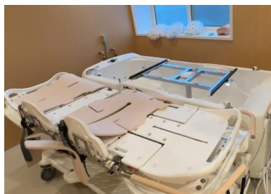
最新ストレッチャー浴設備
