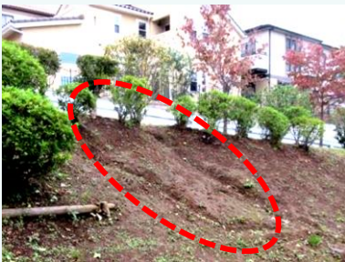
▲のり面の浸食 崩落の恐れがある
